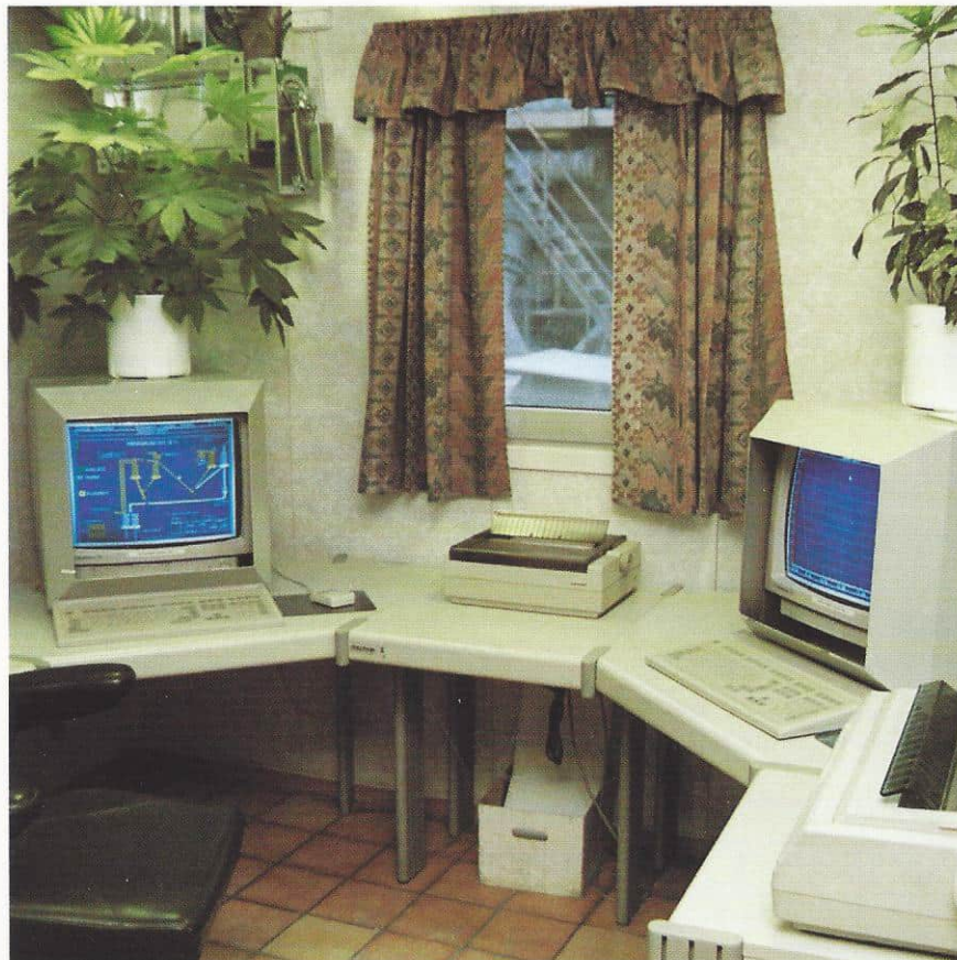
Fra felles kontrollrom ved Hydro Aluminium i Årdal. Fjernstyring av anleggene bygger på Simatic-teknologi.
