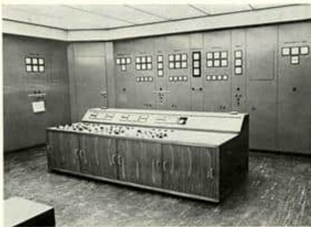
Generatorpultene foran tavlefeltene for generatorer og transformatorer. Tavlefeltet til venstre er for linjen til Sverige.
