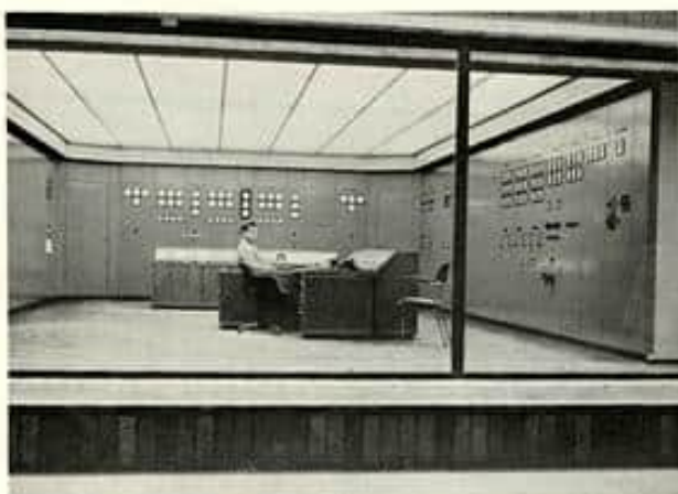
Her ser vi inn i kontrollrommet fra maskinsalen. Generatorpultene står i bakgrunnen, skrivebordet foran.
